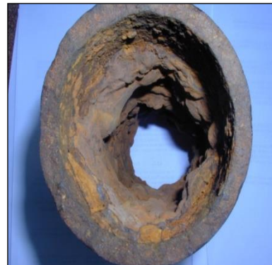
Entartage de canalisation
